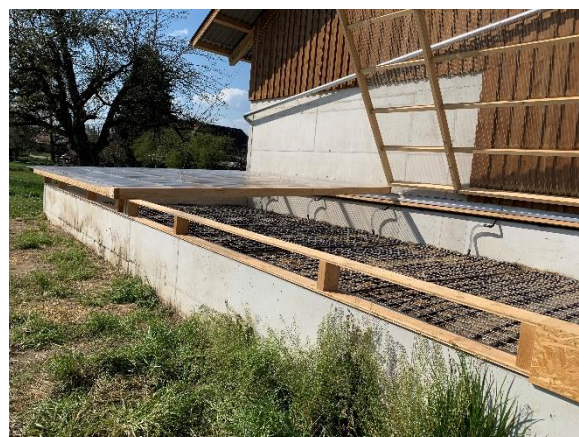
Abb. 3: Betoneinfassung mit Phytobac® Bewässerungssystem (Foto: U.Wyss AG).
