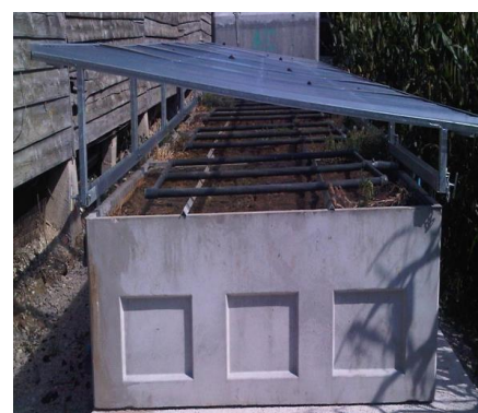
Abb. 2: Auf Beton basierende Biobac®-Anlage mit durchsichtigem Regendach. Foto: Kt. Waadt
